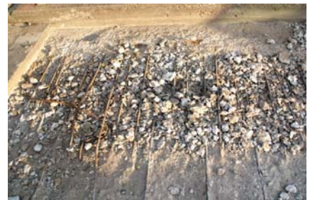
写真1：床版上面損傷例
